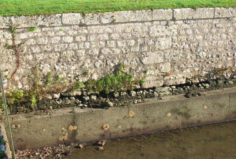
Mur E : maçonnerie désolidarisée et menaçant de ruine
